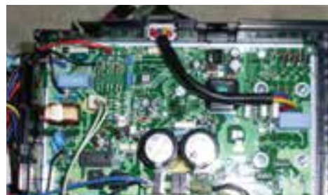
แผงวงจร inverter
