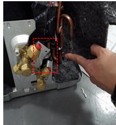
เช็คตำแหน่งเซ็นเซอร์ที่ท่อ cond out คอยล์ร้อน
